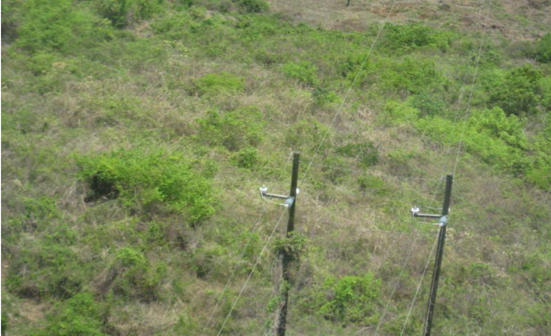
POSTES DEL TENDIDO ELECTRICO
