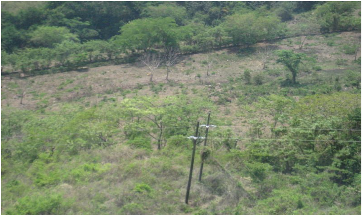
CABLE NEUTRO PASA POR PARTE SUPERIOR DE LOS POSTES
